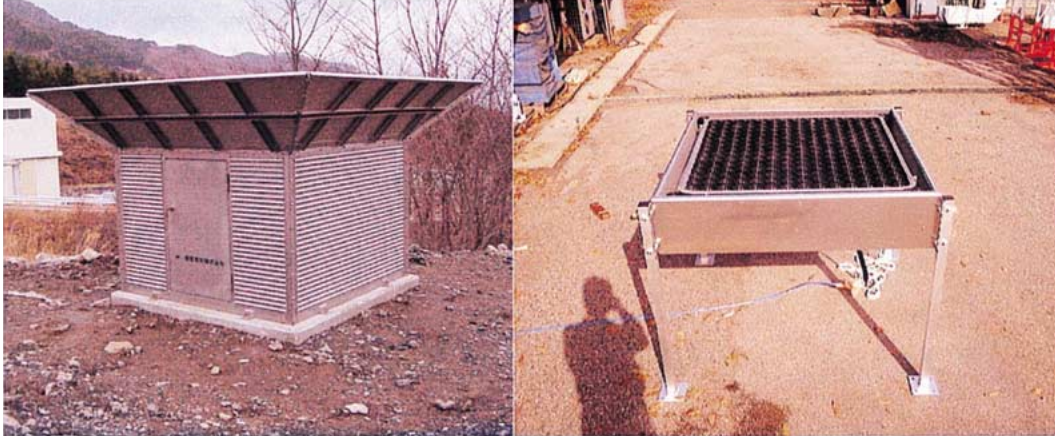
防風板を取り付けた状態（運用状態） 防風板内部のアンテナ 図4 本装置のアンテナ外観図
