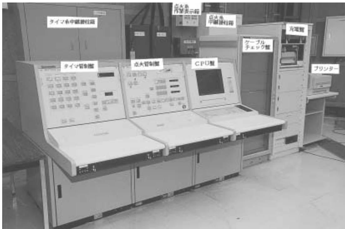
写真-1 点火タイム管制装置
