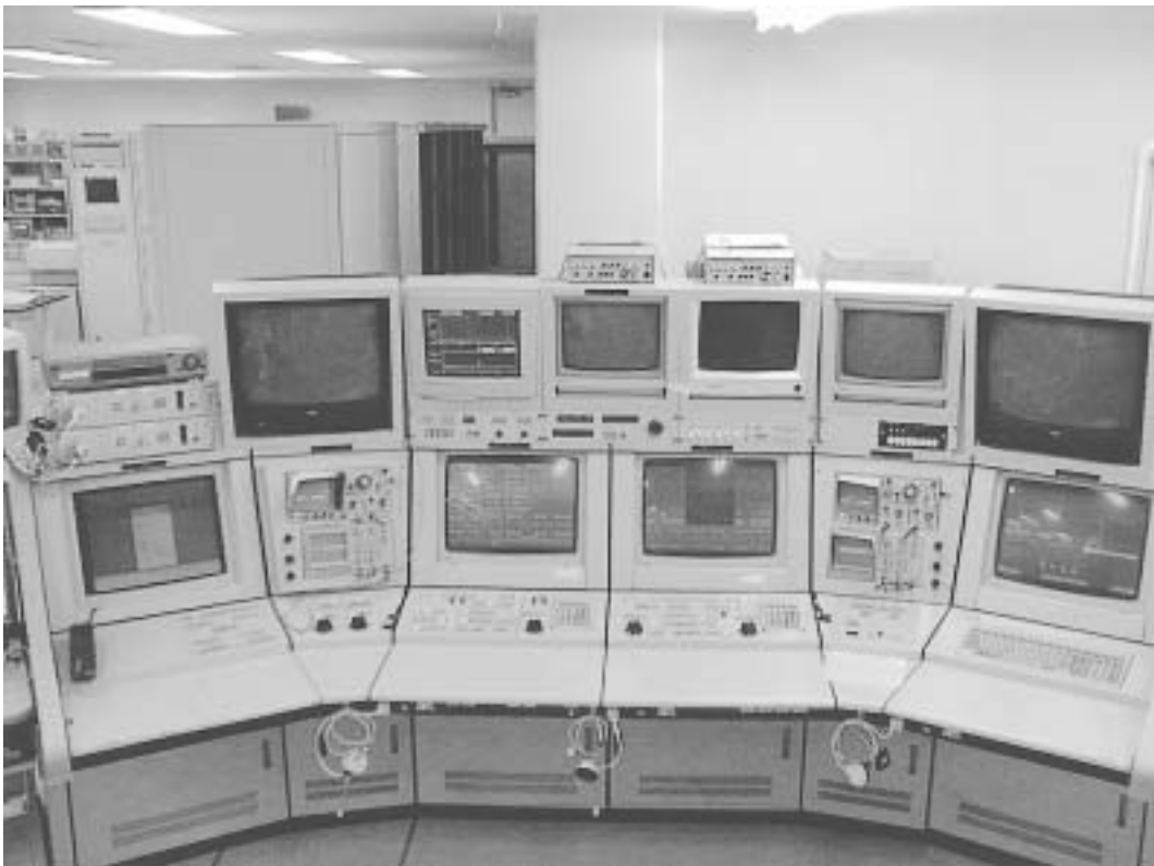
図3 新精測レーダ運用管制コンソール外観写真
