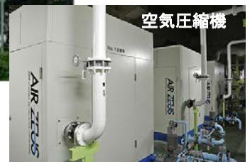
高圧空気源設備
