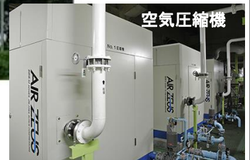
高圧空気源設備
