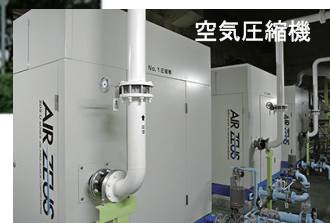
高圧空気源設備
