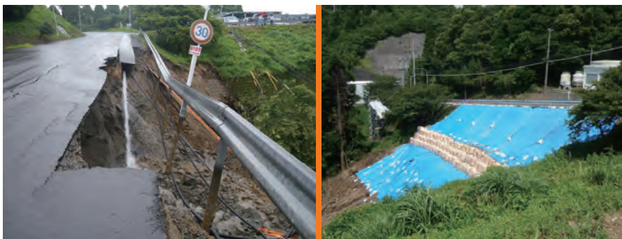
内之浦宇宙空間観測所の門衛所～計器センター間の崩落した道路。 左は2012年6月28日午前9時撮影、右は復旧後の2012年7月24日撮影。
