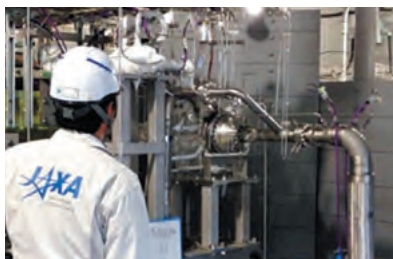
試験後の液体酸素ターボポンプを点検する技術実証チーム員
