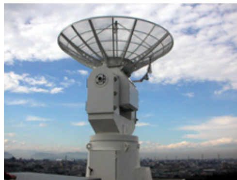
図1 相模原キャンパス屋上に設置された3mアンテナ
