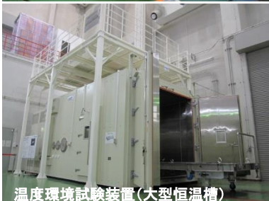
温度環境試験装置(大型恒温槽)
