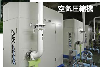
高圧空気源設備
