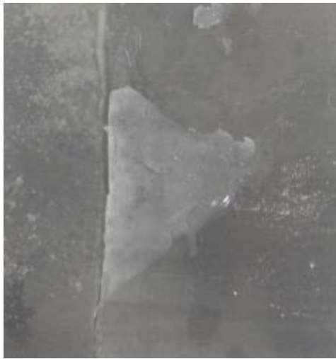
衝突による衝撃で剥離した
