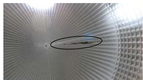
図 6 引き裂き後のパネルの状態
