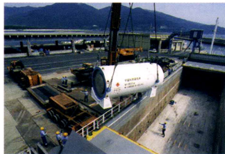
船から大型トレーラに積み込まれるM-14モータのセグメント1（内之浦港）
