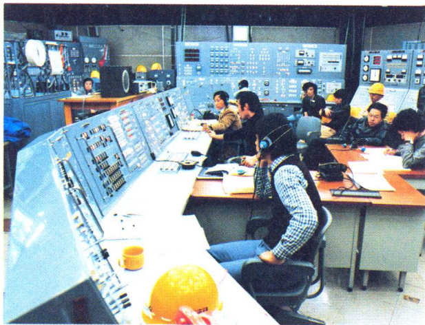
緊張高まるM管制室
